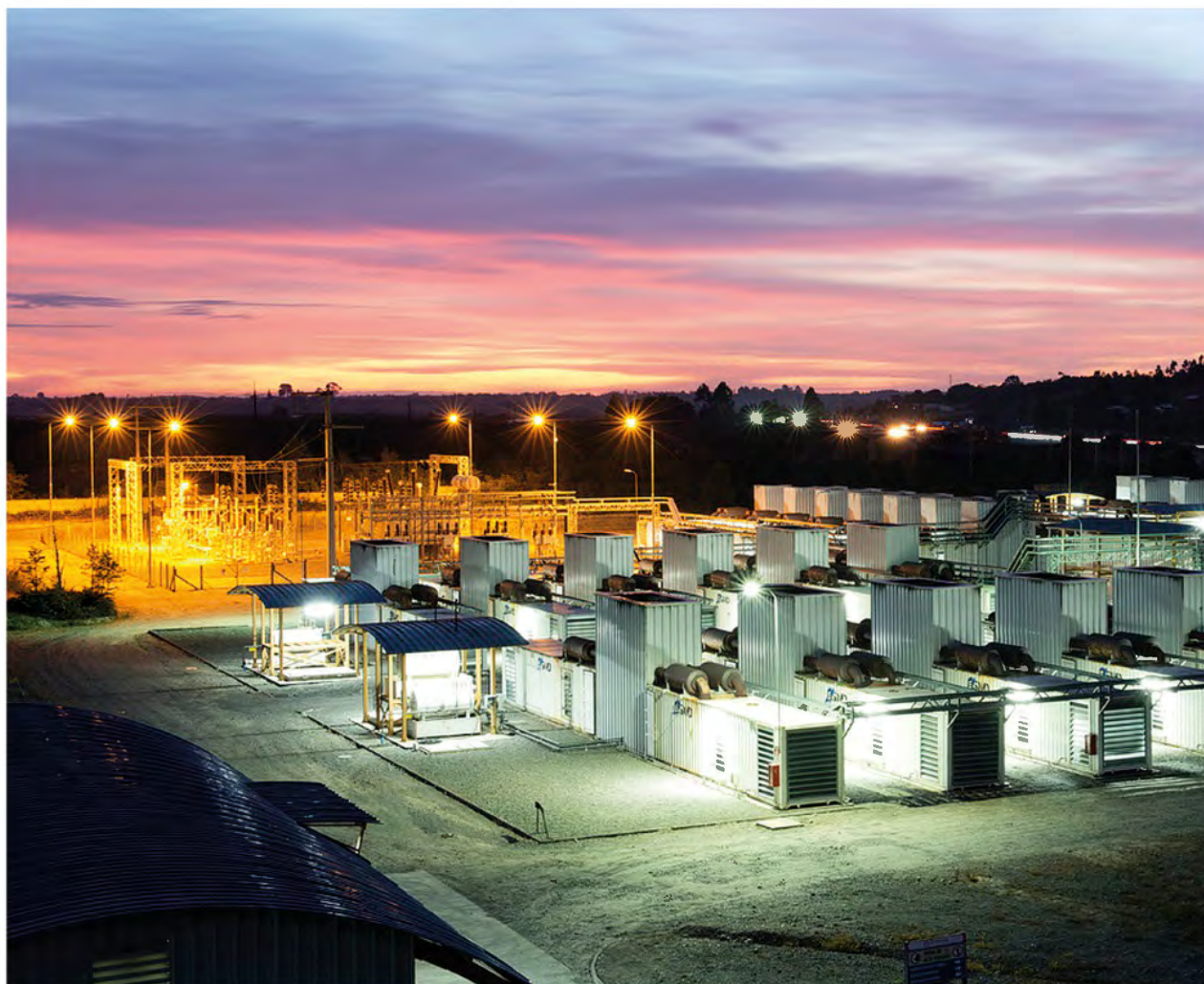
Central Trapén / Fuente: Enlasa.
